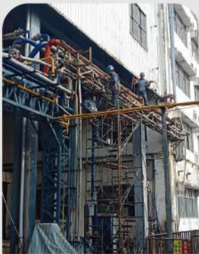
廠區架空管路檢整1
