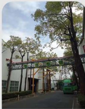
廠區架空管路檢整2
